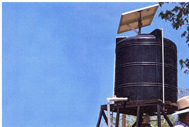
Sistema de bombeo solar huerto familiar de la EDALL
