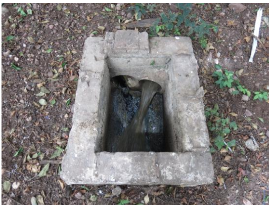
I) Cajas de drenajes expuestas sin protección.
