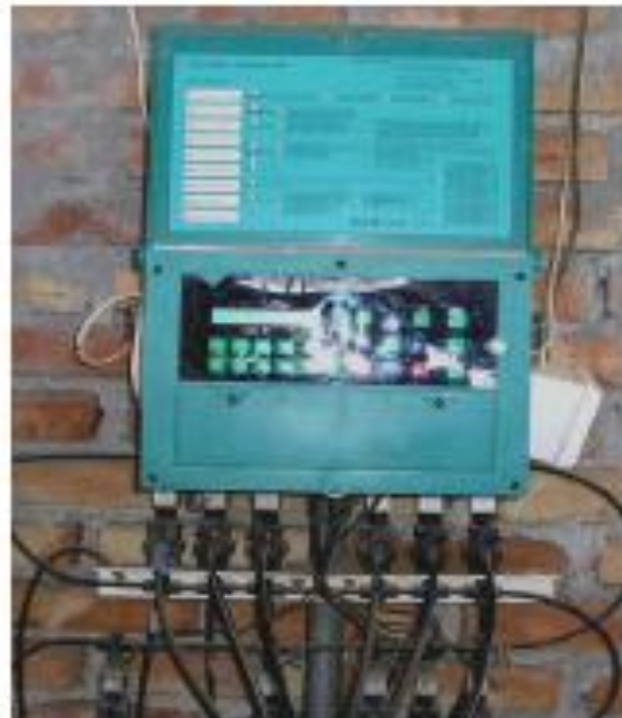
Caja de control
