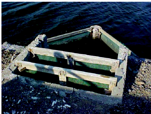
Figura 3. Los filtros en las compuertas de entrada y salida de los estanques deben ser limpiados, revisados y reparados frecuentemente para evitar la fuga de camarones o la entrada de predadores.
